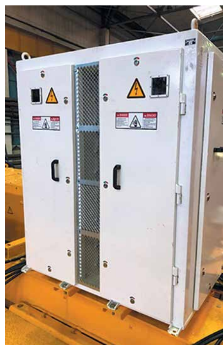
Шкаф управления 75306Е, установленный на палубе дизель-троллейвоза
